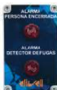
Alarma FG dos refrigerantes
